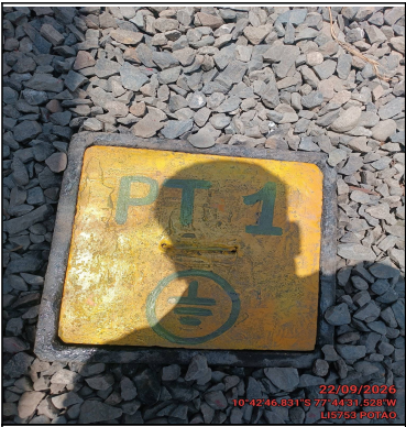
Pozo a tierra
