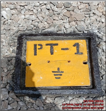
Pozo a tierra
