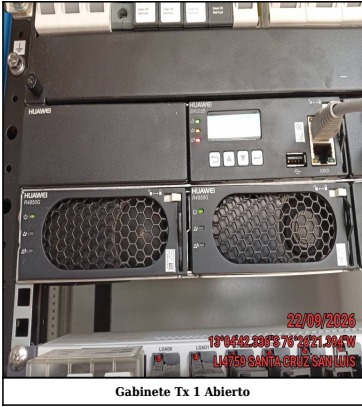
Gabinete Tx 1 Abierto
