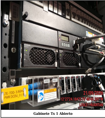
Gabinete Tx 1 Abierto
