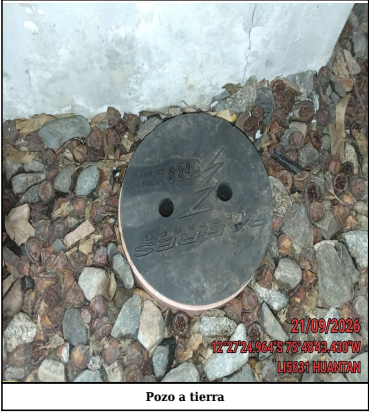
Pozo a tierra
