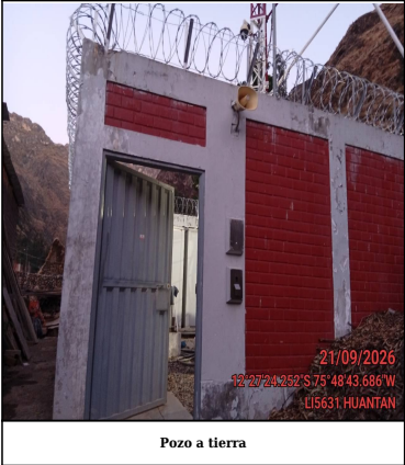
Pozo a tierra
