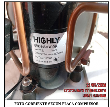
FOTO CORRIENTE SEGUN PLACA COMPRESOR
