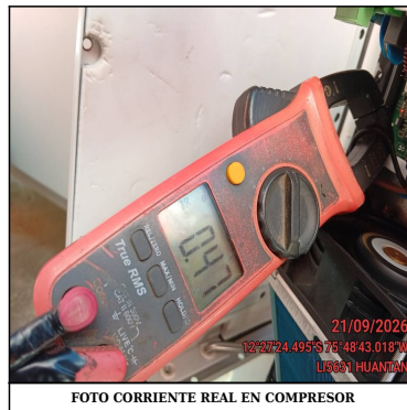
FOTO CORRIENTE REAL EN COMPRESOR
