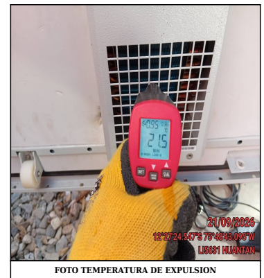
FOTO TEMPERATURA DE EXPULSION
