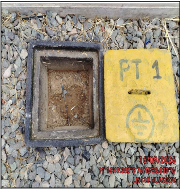
Pozo a tierra
