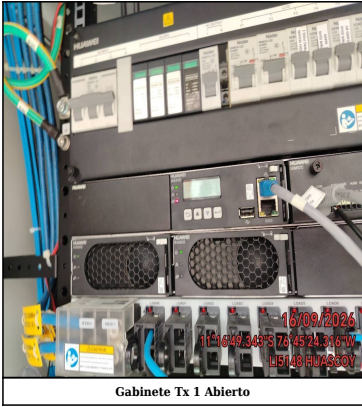
Gabinete Tx 1 Abierto
