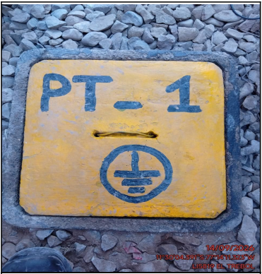
Pozo a tierra
