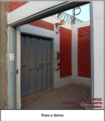
Pozo a tierra
