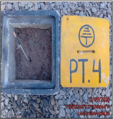
Pozo a tierra
