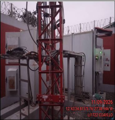
Foto Panorámica del Interior del Site
