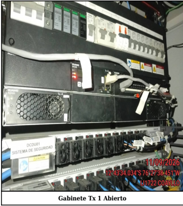
Gabinete Tx 1 Abierto
