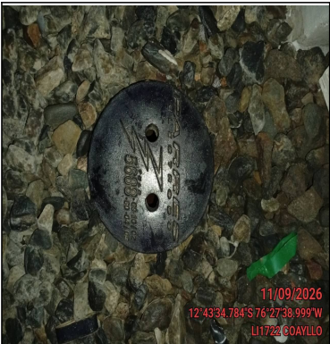
Pozo a tierra
