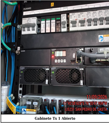
Gabinete Tx 1 Abierto
