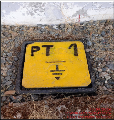
Pozo a tierra
