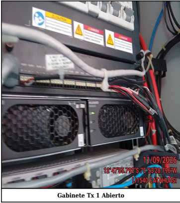
Gabinete Tx 1 Abierto
