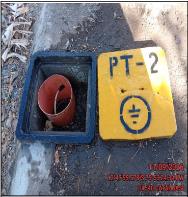
Pozo a tierra
