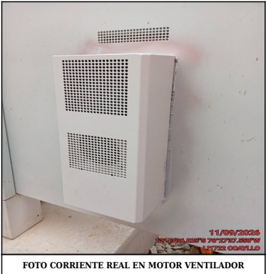
FOTO CORRIENTE REAL EN MOTOR VENTILADOR
