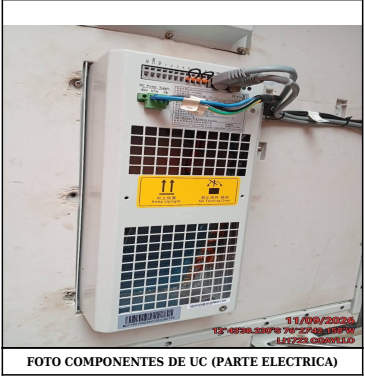
FOTO COMPONENTES DE UC (PARTE ELECTRICA)
