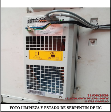
FOTO LIMPIEZA Y ESTADO DE SERPENTIN DE UC
