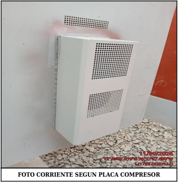
FOTO CORRIENTE SEGUN PLACA COMPRESOR
