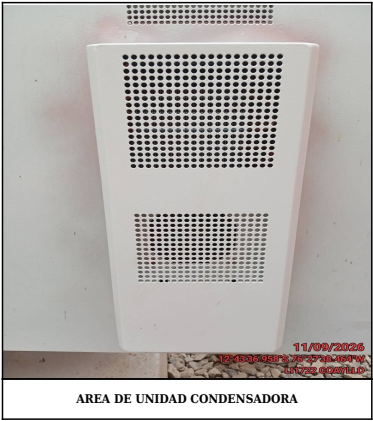
AREA DE UNIDAD CONDENSADORA
