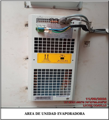
AREA DE UNIDAD EVAPORADORA
