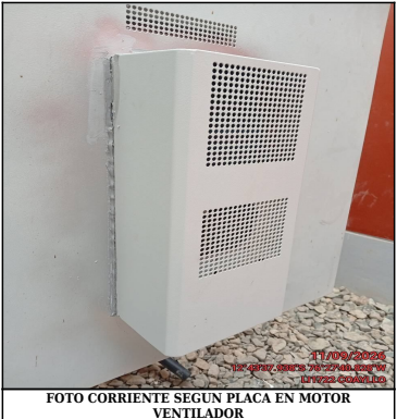
FOTO CORRIENTE SEGUN PLACA EN MOTOR VENTILADOR
