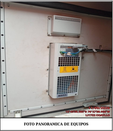
FOTO PANORAMICA DE EQUIPOS
