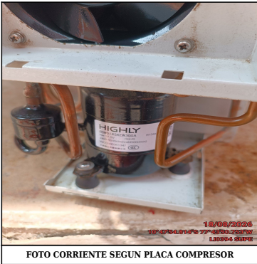
FOTO CORRIENTE SEGUN PLACA COMPRESOR
