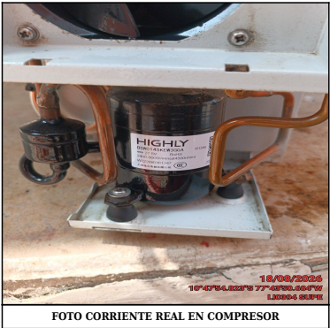
FOTO CORRIENTE REAL EN COMPRESOR
