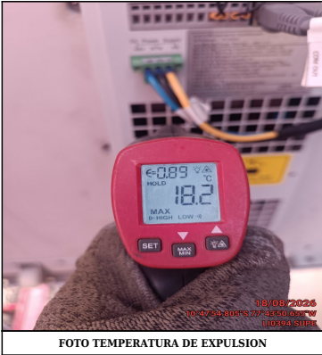
FOTO TEMPERATURA DE EXPULSION
