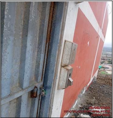
Pozo a tierra
