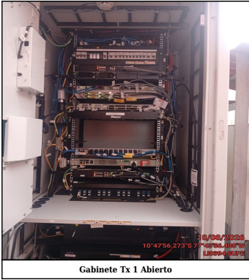
Gabinete Tx 1 Abierto
