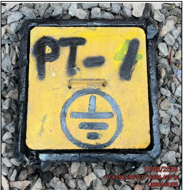
Pozo a tierra
