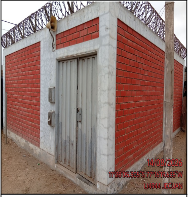
Pozo a tierra
