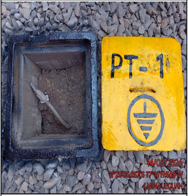
Pozo a tierra
