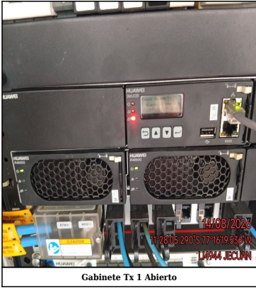
Gabinete Tx 1 Abierto
