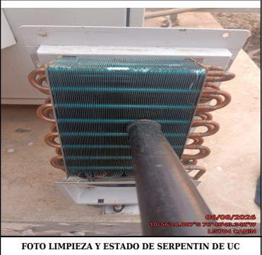
FOTO LIMPIEZA Y ESTADO DE SERPENTIN DE UC
