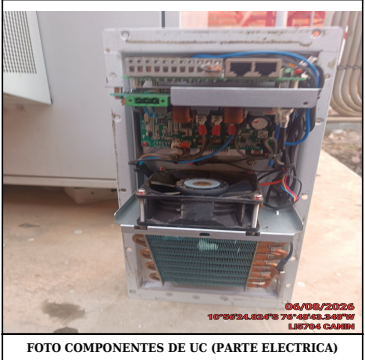
FOTO COMPONENTES DE UC (PARTE ELECTRICA)
