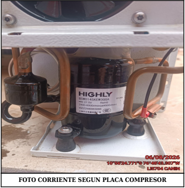
FOTO CORRIENTE SEGUN PLACA COMPRESOR
