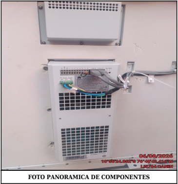
FOTO PANORAMICA DE COMPONENTES
