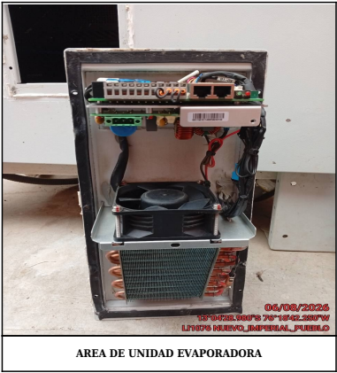
AREA DE UNIDAD EVAPORADORA
