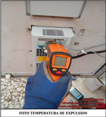
FOTO TEMPERATURA DE EXPULSION
