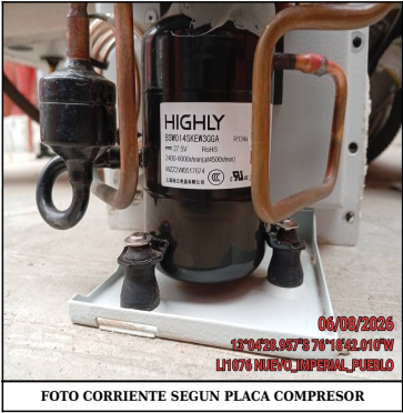
FOTO CORRIENTE SEGUN PLACA COMPRESOR
