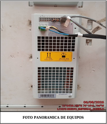
FOTO PANORAMICA DE EQUIPOS
