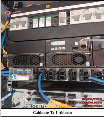
Gabinete Tx 1 Abierto
