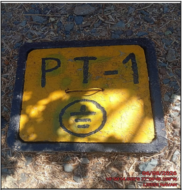
Pozo a tierra
