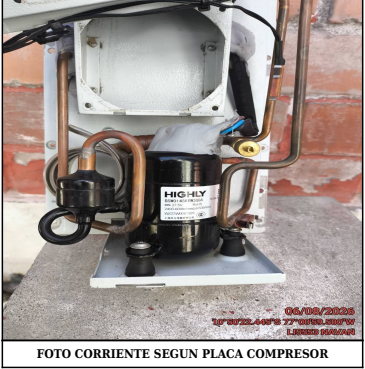
FOTO CORRIENTE SEGUN PLACA COMPRESOR
