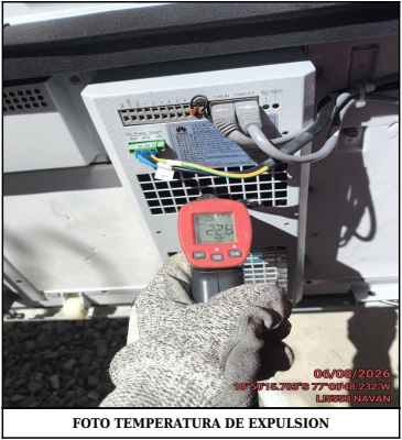
FOTO TEMPERATURA DE EXPULSION
