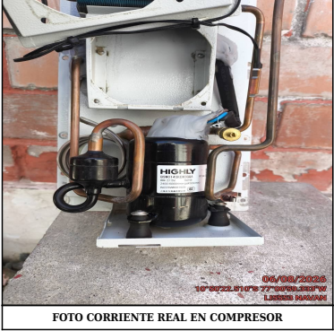
FOTO CORRIENTE REAL EN COMPRESOR
