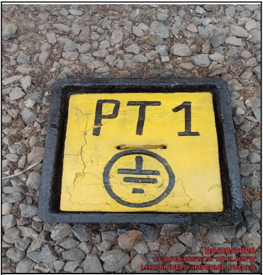
Pozo a tierra
