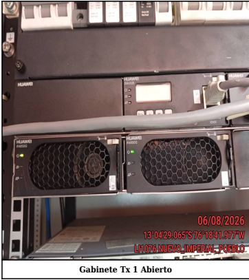
Gabinete Tx 1 Abierto
