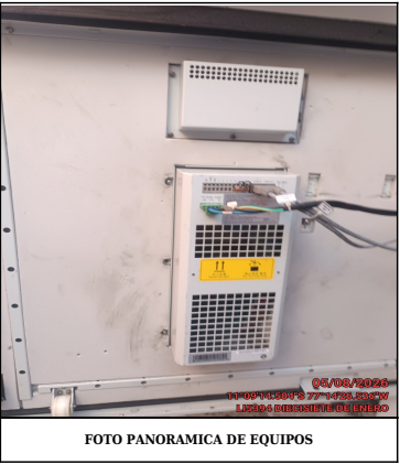
FOTO PANORAMICA DE EQUIPOS
