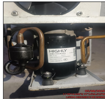
FOTO CORRIENTE SEGUN PLACA COMPRESOR
