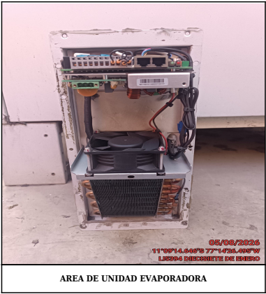
AREA DE UNIDAD EVAPORADORA
