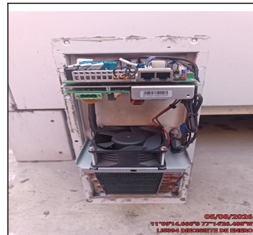
FOTO COMPONENTES DE UC (PARTE ELECTRICA)
