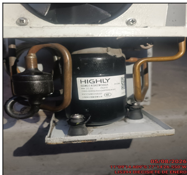
FOTO CORRIENTE REAL EN COMPRESOR
