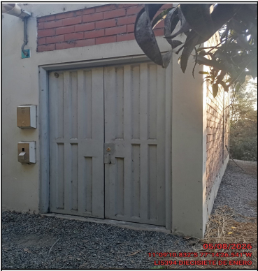
Pozo a tierra
