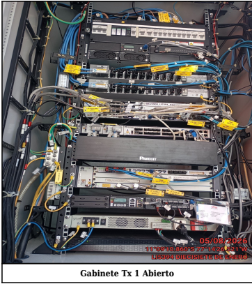
Gabinete Tx 1 Abierto
