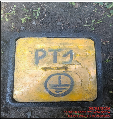
Pozo a tierra
