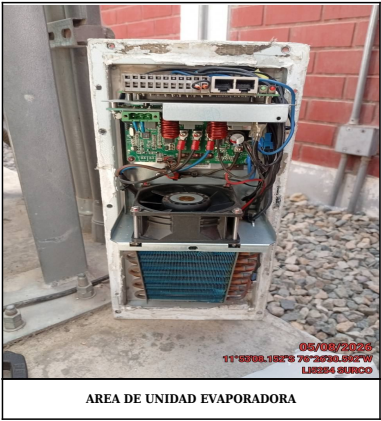
AREA DE UNIDAD EVAPORADORA
