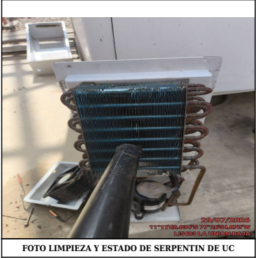
FOTO LIMPIEZA Y ESTADO DE SERPENTIN DE UC
