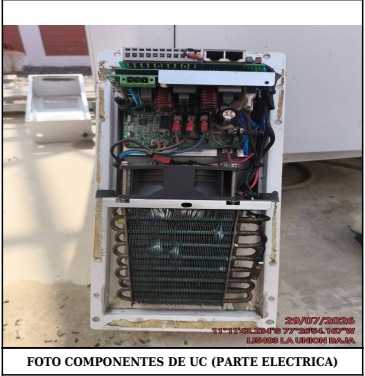
FOTO COMPONENTES DE UC (PARTE ELECTRICA)
