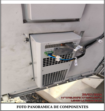
FOTO PANORAMICA DE COMPONENTES
