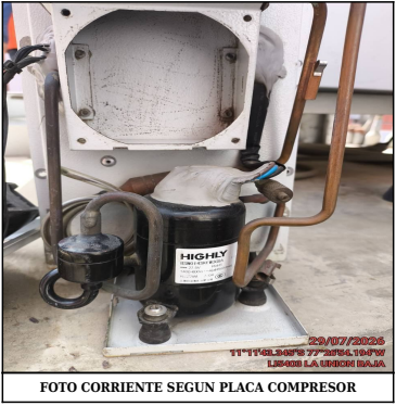
FOTO CORRIENTE SEGUN PLACA COMPRESOR
