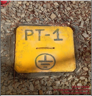
Pozo a tierra
