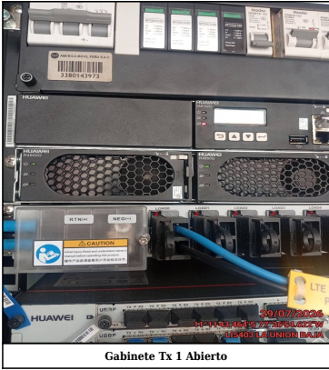
Gabinete Tx 1 Abierto
