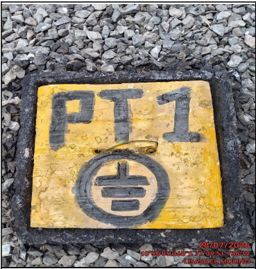
Pozo a tierra
