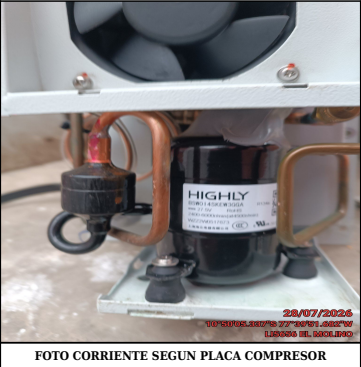
FOTO CORRIENTE SEGUN PLACA COMPRESOR
