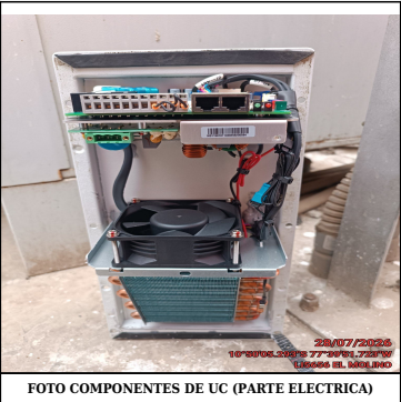
FOTO COMPONENTES DE UC (PARTE ELECTRICA)
