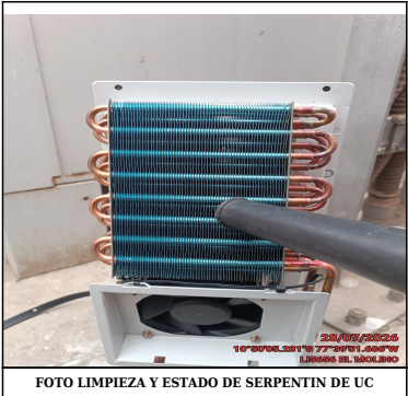
FOTO LIMPIEZA Y ESTADO DE SERPENTIN DE UC
