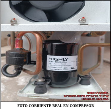
FOTO CORRIENTE REAL EN COMPRESOR
