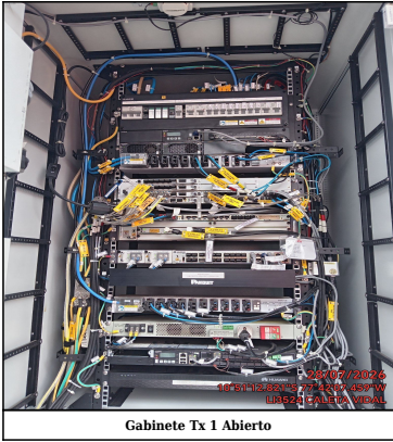
Gabinete Tx 1 Abierto
