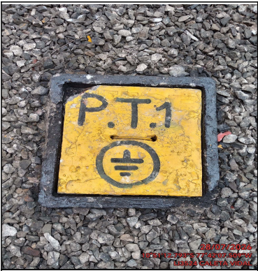
Pozo a tierra
