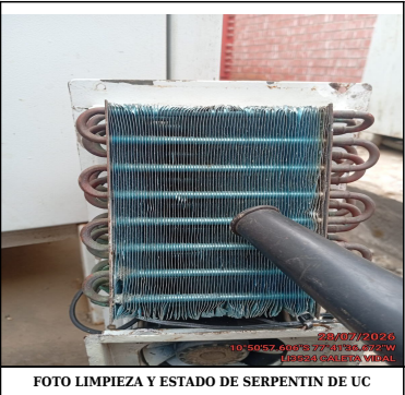
FOTO LIMPIEZA Y ESTADO DE SERPENTIN DE UC
