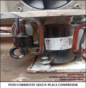
FOTO CORRIENTE SEGUN PLACA COMPRESOR
