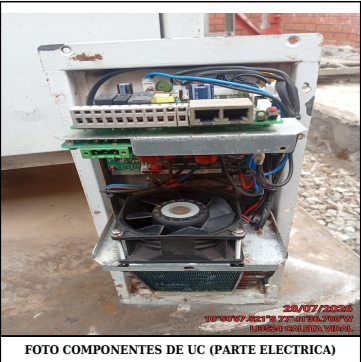
FOTO COMPONENTES DE UC (PARTE ELECTRICA)
