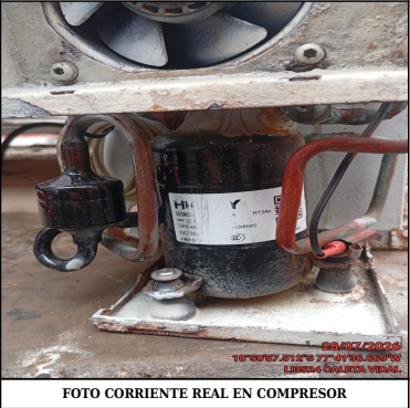
FOTO CORRIENTE REAL EN COMPRESOR
