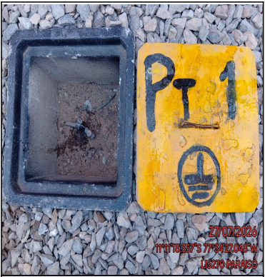
Pozo a tierra
