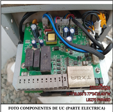
FOTO COMPONENTES DE UC (PARTE ELECTRICA)
