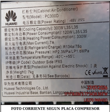
FOTO CORRIENTE SEGUN PLACA COMPRESOR
