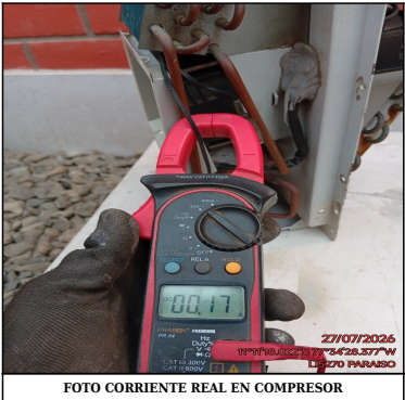
FOTO CORRIENTE REAL EN COMPRESOR
