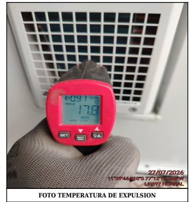
FOTO TEMPERATURA DE EXPULSION
