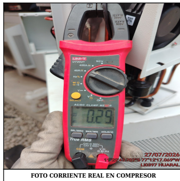
FOTO CORRIENTE REAL EN COMPRESOR
