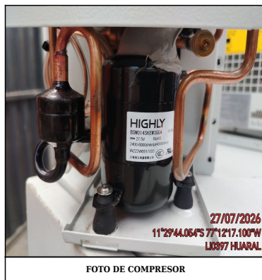
FOTO DE COMPRESOR
