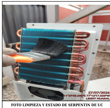
FOTO LIMPIEZA Y ESTADO DE SERPENTIN DE UC
