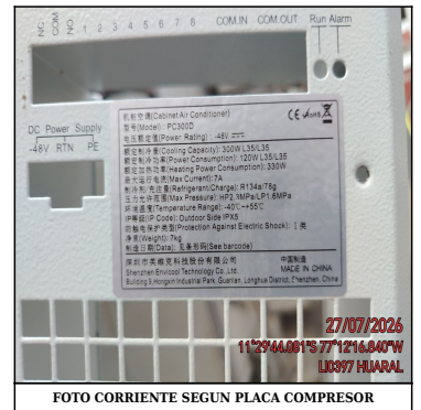
FOTO CORRIENTE SEGUN PLACA COMPRESOR
