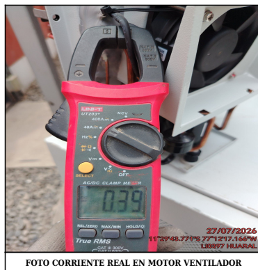
FOTO CORRIENTE REAL EN MOTOR VENTILADOR
