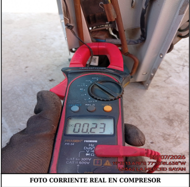
FOTO CORRIENTE REAL EN COMPRESOR
