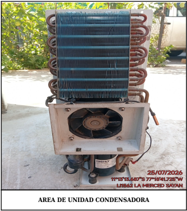
AREA DE UNIDAD CONDENSADORA
