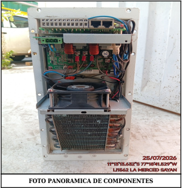
FOTO PANORAMICA DE COMPONENTES
