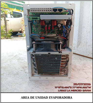
AREA DE UNIDAD EVAPORADORA
