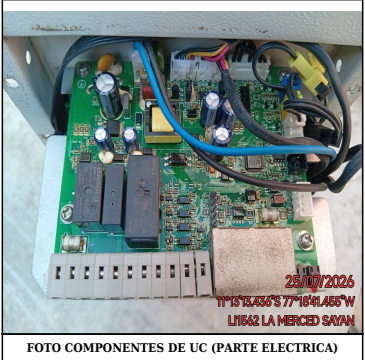
FOTO COMPONENTES DE UC (PARTE ELECTRICA)
