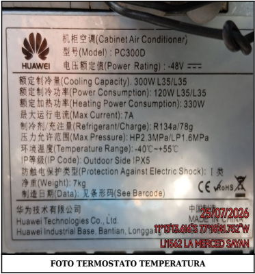
FOTO TERMOSTATO TEMPERATURA
