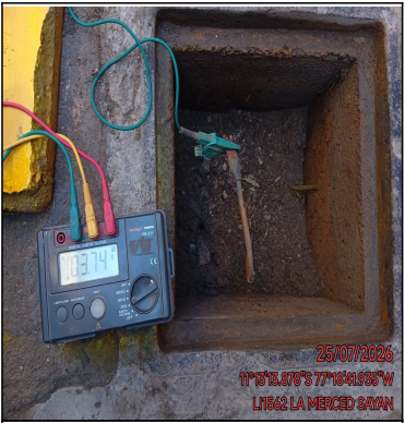
Pozo a tierra
