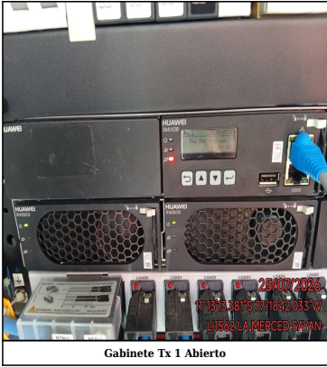
Gabinete Tx 1 Abierto
