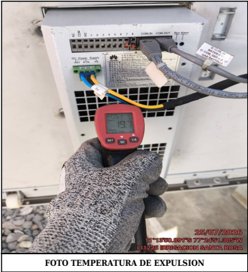
FOTO TEMPERATURA DE EXPULSION
