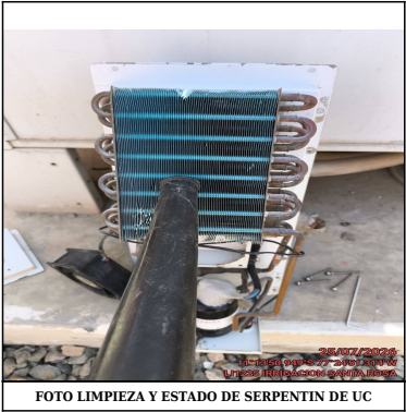
FOTO LIMPIEZA Y ESTADO DE SERPENTIN DE UC
