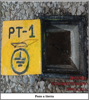
Pozo a tierra
