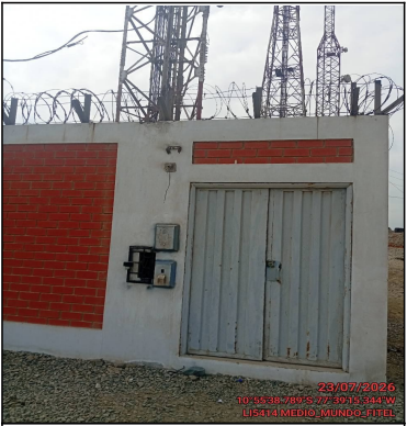
Pozo a tierra
