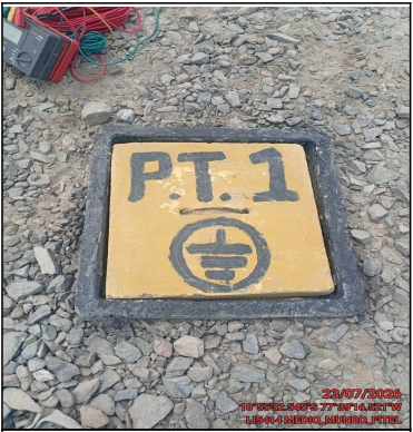
Pozo a tierra
