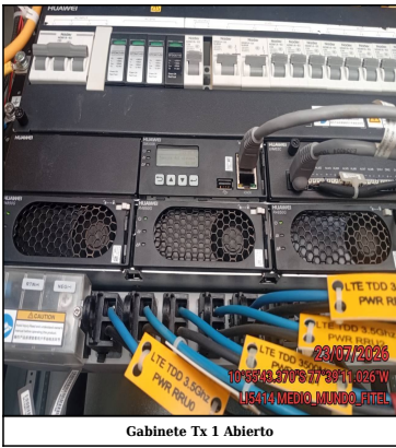
Gabinete Tx 1 Abierto
