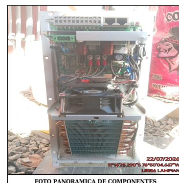
FOTO PANORAMICA DE COMPONENTES
