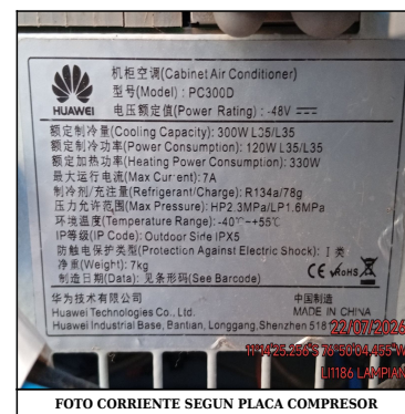
FOTO CORRIENTE SEGUN PLACA COMPRESOR
