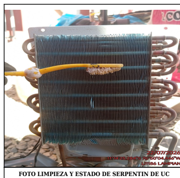
FOTO LIMPIEZA Y ESTADO DE SERPENTIN DE UC
