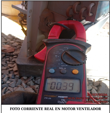
FOTO CORRIENTE REAL EN MOTOR VENTILADOR
