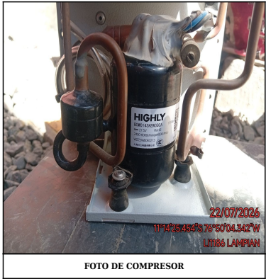
FOTO DE COMPRESOR
