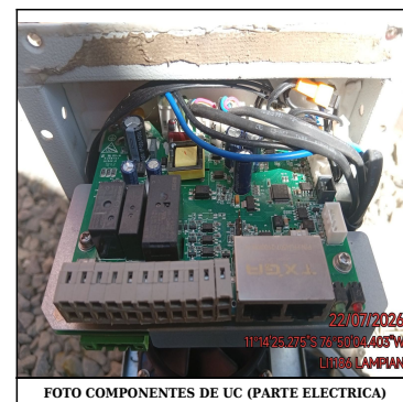
FOTO COMPONENTES DE UC (PARTE ELECTRICA)
