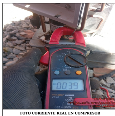
FOTO CORRIENTE REAL EN COMPRESOR
