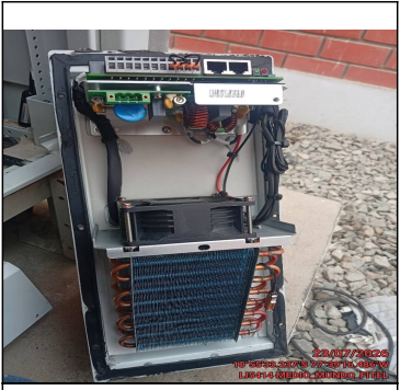
FOTO COMPONENTES DE UC (PARTE ELECTRICA)
