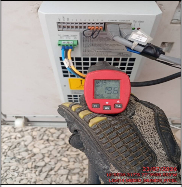
FOTO TEMPERATURA DE EXPULSION
