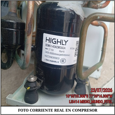
FOTO CORRIENTE REAL EN COMPRESOR
