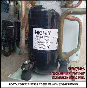
FOTO CORRIENTE SEGUN PLACA COMPRESOR
