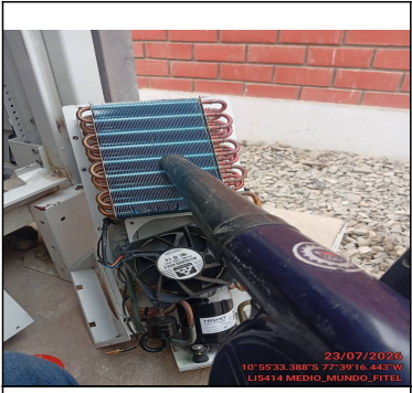
FOTO LIMPIEZA Y ESTADO DE SERPENTIN DE UC
