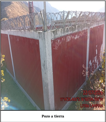
Pozo a tierra
