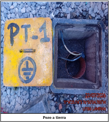
Pozo a tierra
