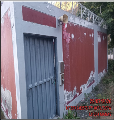
Pozo a tierra
