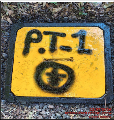
Pozo a tierra
