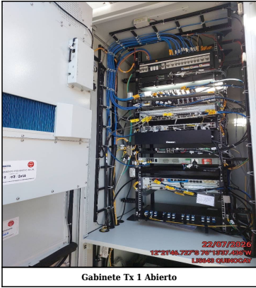
Gabinete Tx 1 Abierto
