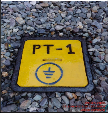
Pozo a tierra
