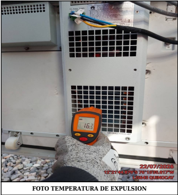
FOTO TEMPERATURA DE EXPULSION
