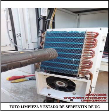
FOTO LIMPIEZA Y ESTADO DE SERPENTIN DE UC
