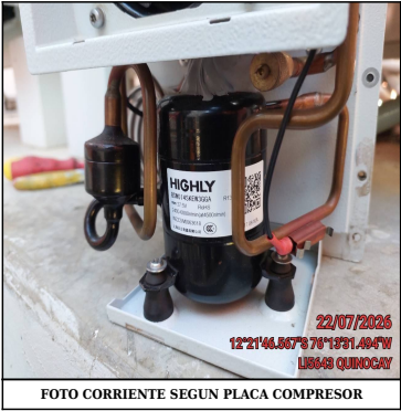
FOTO CORRIENTE SEGUN PLACA COMPRESOR
