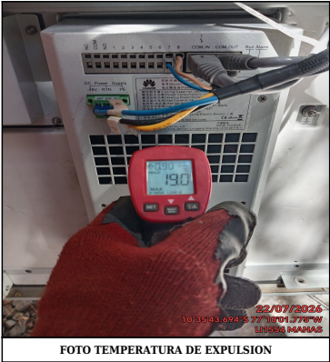
FOTO TEMPERATURA DE EXPULSION
