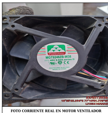
FOTO CORRIENTE REAL EN MOTOR VENTILADOR
