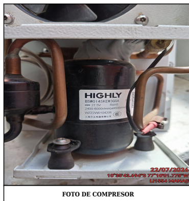
FOTO DE COMPRESOR
