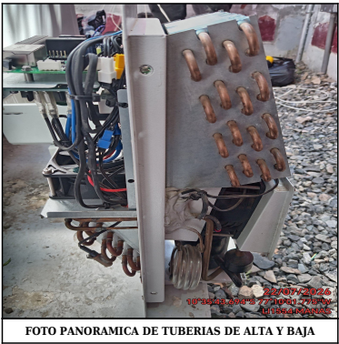
FOTO PANORAMICA DE TUBERIAS DE ALTA Y BAJA
