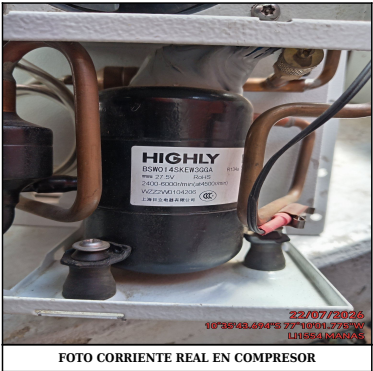
FOTO CORRIENTE REAL EN COMPRESOR
