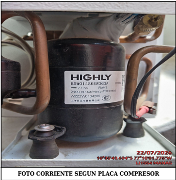
FOTO CORRIENTE SEGUN PLACA COMPRESOR
