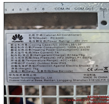
FOTO DE PLACA DE UNIDAD CONDENSADORA
