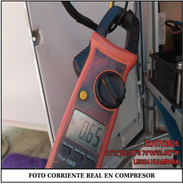
FOTO CORRIENTE REAL EN COMPRESOR
