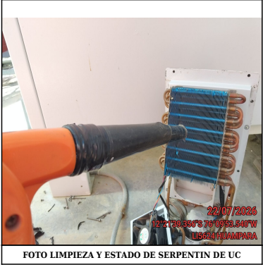
FOTO LIMPIEZA Y ESTADO DE SERPENTIN DE UC
