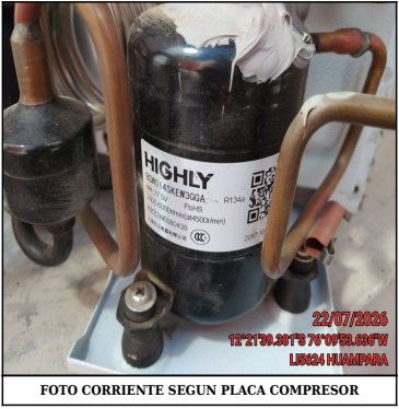
FOTO CORRIENTE SEGUN PLACA COMPRESOR
