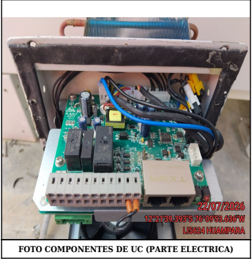
FOTO COMPONENTES DE UC (PARTE ELECTRICA)
