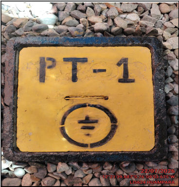
Pozo a tierra
