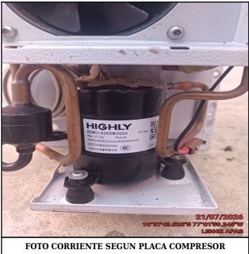
FOTO CORRIENTE SEGUN PLACA COMPRESOR
