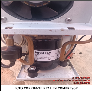
FOTO CORRIENTE REAL EN COMPRESOR
