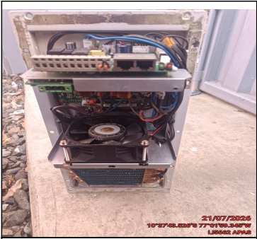
FOTO COMPONENTES DE UC (PARTE ELECTRICA)
