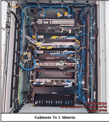
Gabinete Tx 1 Abierto
