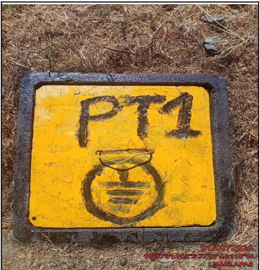
Pozo a tierra
