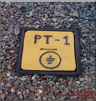
Pozo a tierra
