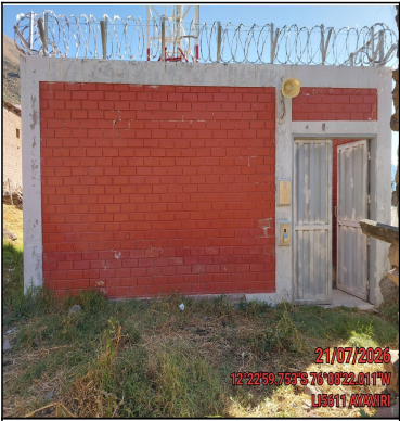
Pozo a tierra
