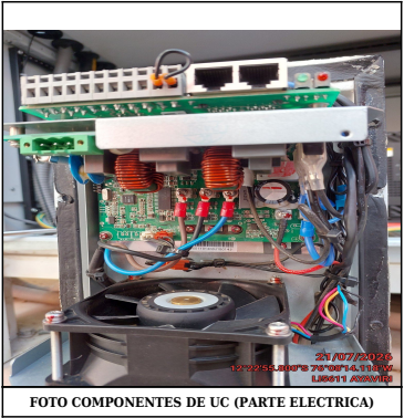
FOTO COMPONENTES DE UC (PARTE ELECTRICA)
