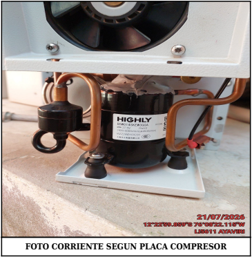
FOTO CORRIENTE SEGUN PLACA COMPRESOR
