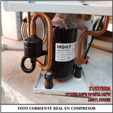
FOTO CORRIENTE REAL EN COMPRESOR
