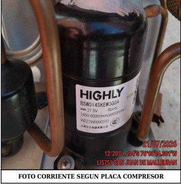
FOTO CORRIENTE SEGUN PLACA COMPRESOR
