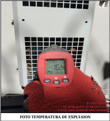
FOTO TEMPERATURA DE EXPULSION
