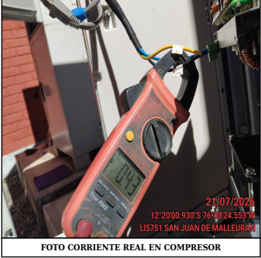
FOTO CORRIENTE REAL EN COMPRESOR
