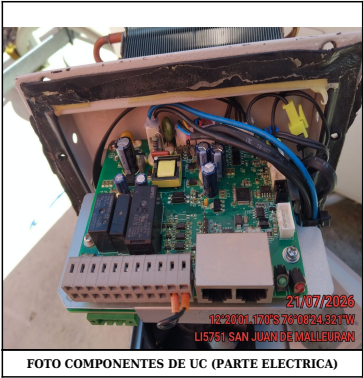
FOTO COMPONENTES DE UC (PARTE ELECTRICA)
